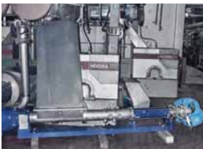
Насос seepex BTM 70-12 , продукт: отходы картофеля от щеточной кожуроочистительной машины для размельчения и последующей транспортировки на декантатор или бункер мезги, давление: до 12 бар, производительность: 40 м 3 /ч
